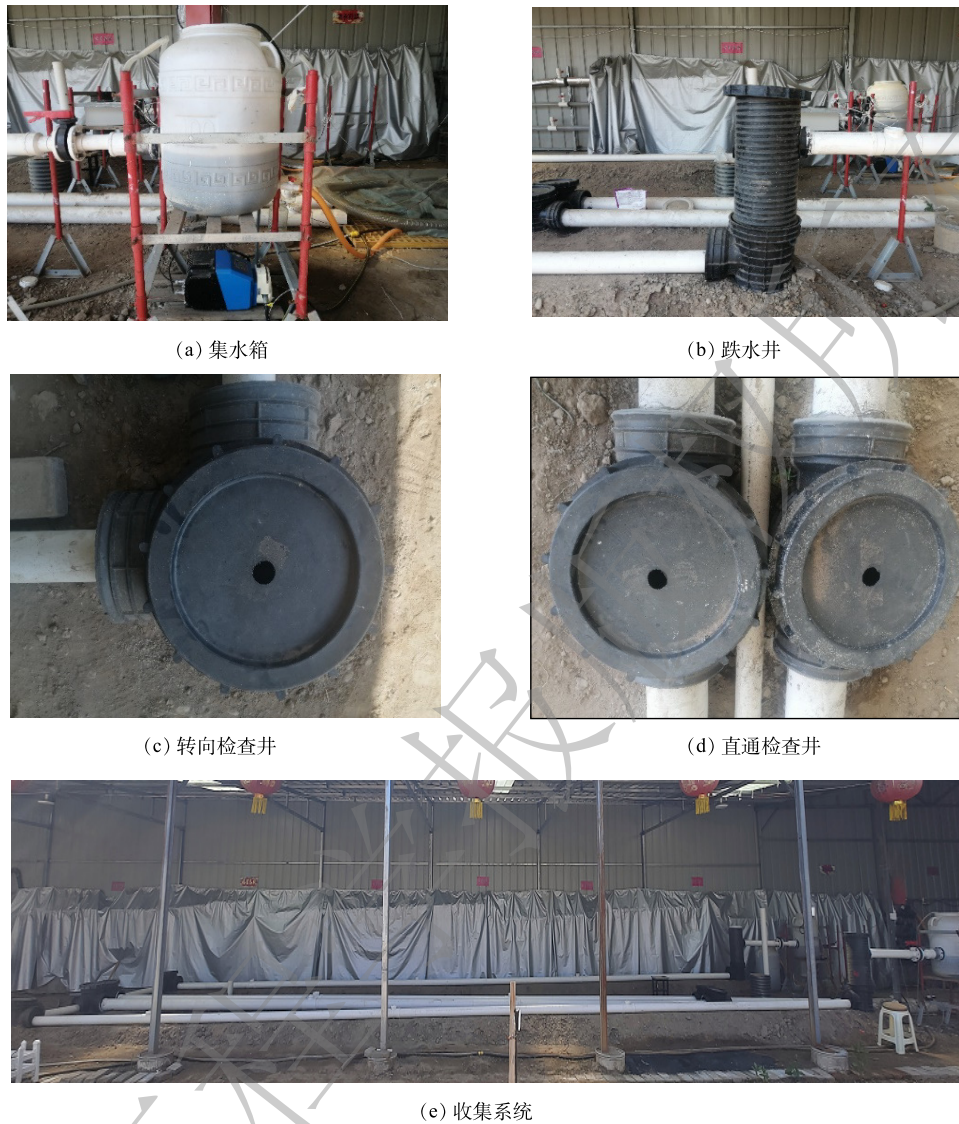
图 2 实验中试系统组成实物图
